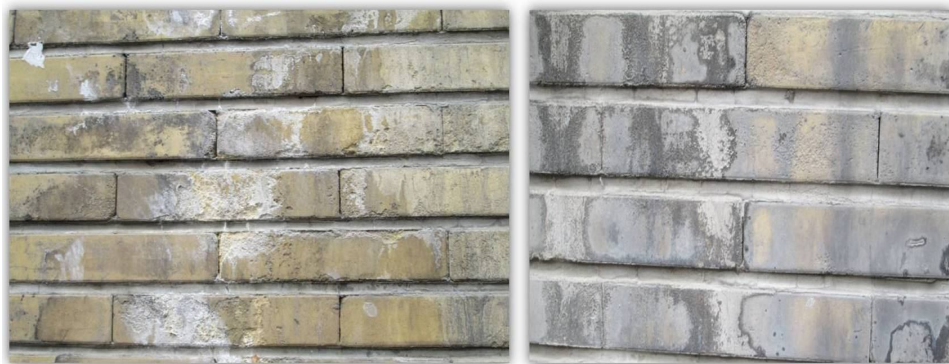
شکل 7: آثار خوردگی سنگ، تغییر رنگ در اثر تخریب شیمیایی و آلودگی نمای آجری ساختمان، تهران میدان راه آهن، دی ماه 1391.
