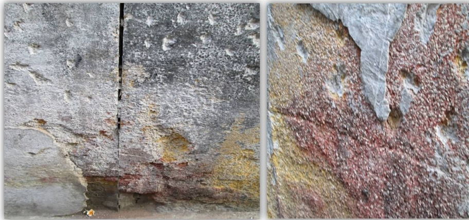
شکل 8: تخریب شیمیایی شدید، تغییر رنگ و حفره حفره شدن، بازشدگی محل اتصال سنگ ها، نمای ساختمان، تهران، بهارستان، کوچه نظامیه، دی ماه 1391.
