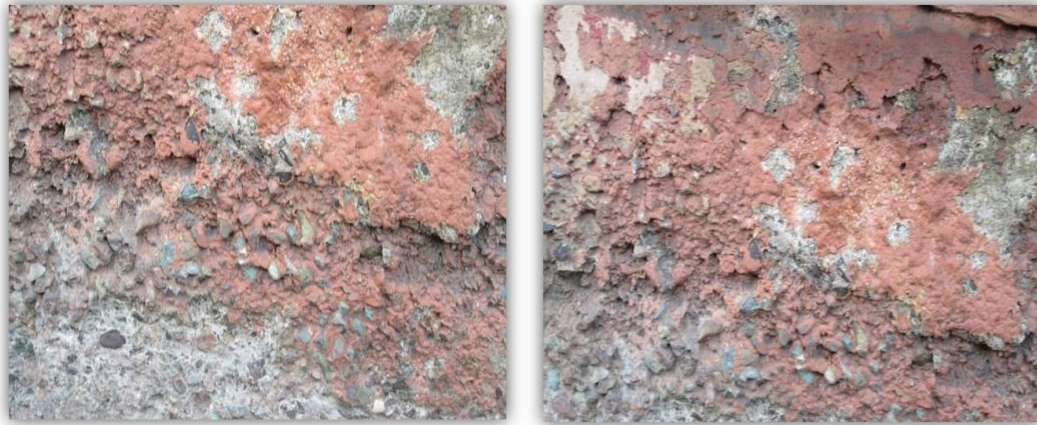
شکل 01: تجزیه و تخریب شیمیایی شدید، تغییر رنگ، پوسته شدن و خردشدگی دانه ای، نمای ساختمان، تهران، خیابان ابوسعید، دی ماه 1391.
