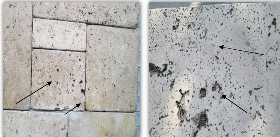
شکل 9: حفره حفره شدن و تغییر رنگ، بازشدگی محل اتصال سنگ ها، نمای ساختمان، تهران، میدان هفتم تیر، خیابان سعدی، دی ماه 1391.
