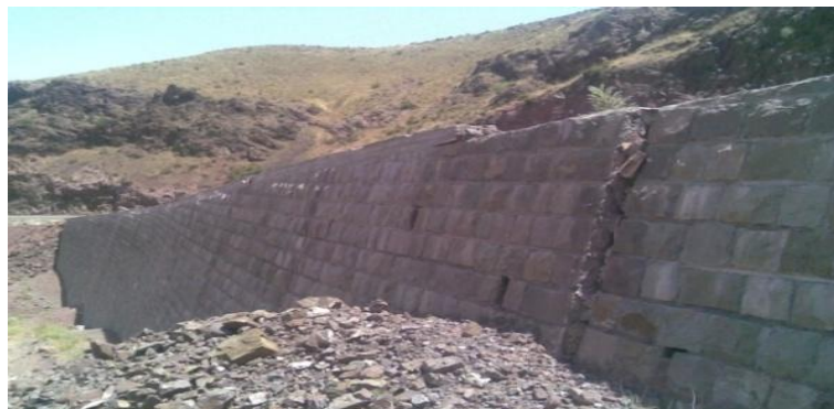
شکل ۱۱: پدیده زمین لغزش (زمین لغزش شماره ۸) و شکستگی دیوار حفاظی جاده
