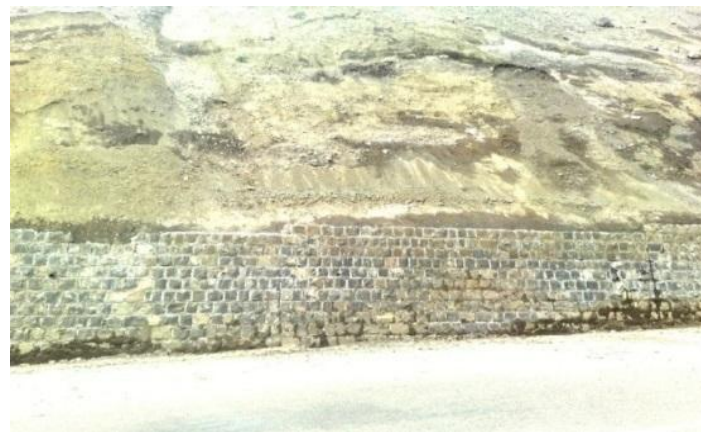
شکل ۹: دیواره سنگی حفاظی نزدیک تونل شماره ۸ جاده اردبیل - سرچم که در اثر جریان‌های زیر سطحی باعث جابجایی توف‌های نرم و ترک برداشتن دیوار شده است.
